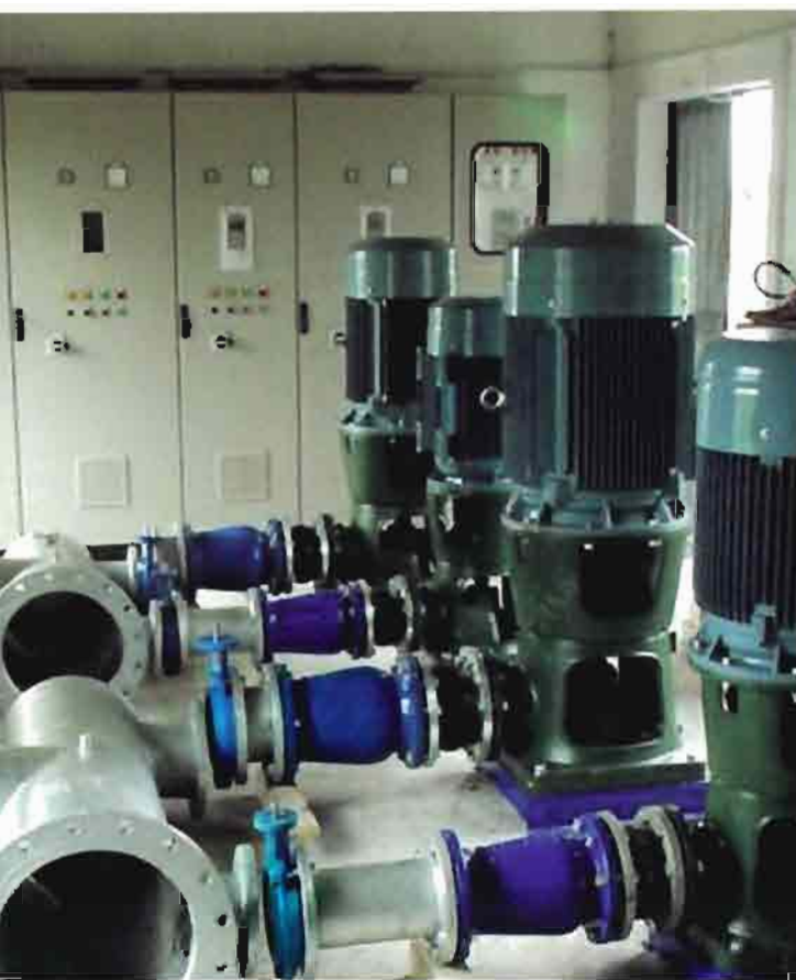
Stazione di pompaggio
